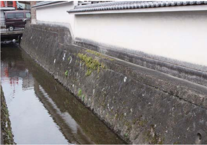
▲擁壁が老朽化したため、沈下して塀にクラックが入りました
